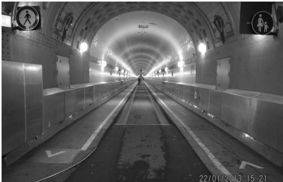
Die noch nicht sanierte westliche Röhre
